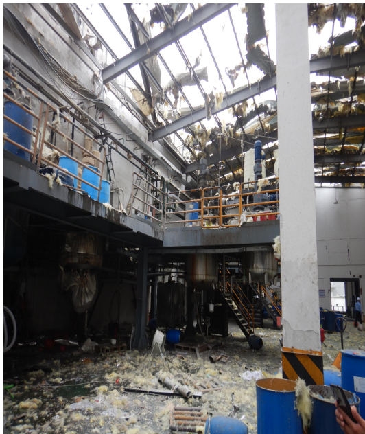
综合车间事故现场
