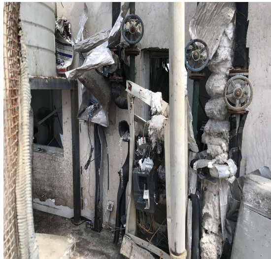
17#釜非防爆控制柜
