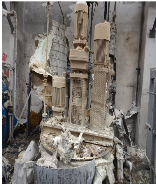
17#釜上部(车间二楼)
