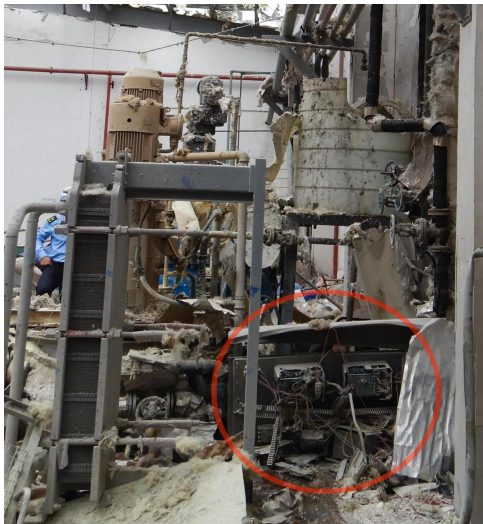
17#釜附近非防爆电气设备
